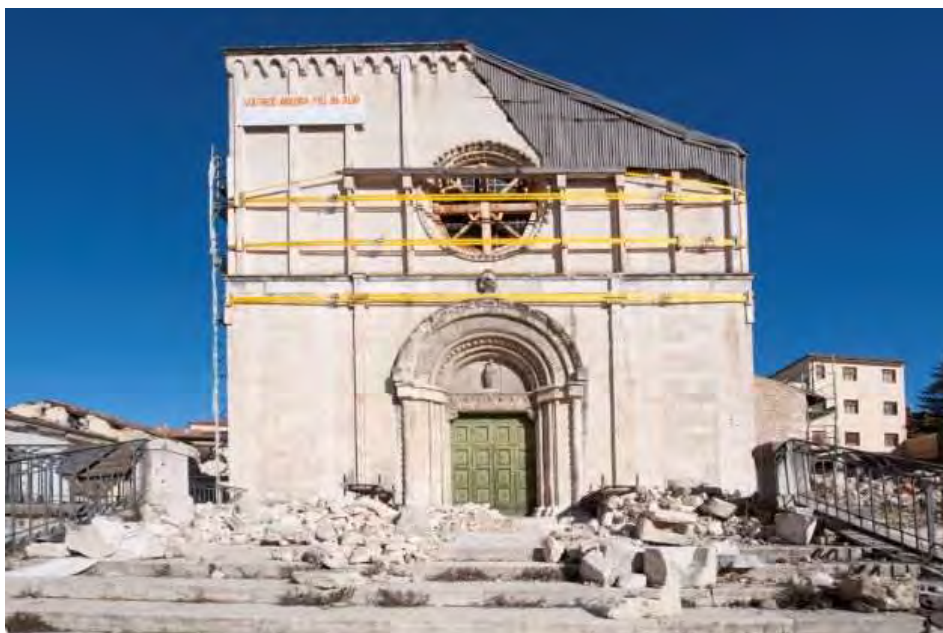
Fig. 3 L'Aquila (AQ), Chiesa di San Pietro di Coppito dopo il sisma
